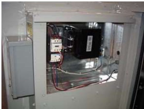
Figure 2 : Raccordement électrique et boîtier haut voltage
